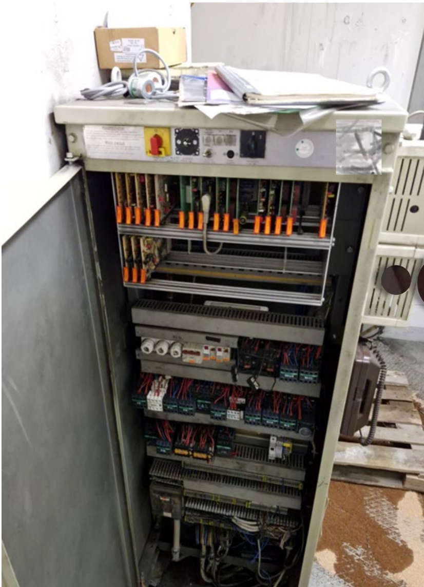
So sieht eine Aufzugssteuerung aus dem Jahr 1995 aus ...
