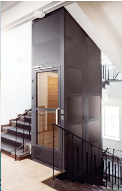
Individuell angepasst an das Treppenhaus
